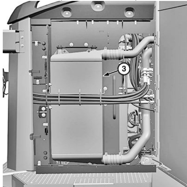
compartimento de enfriador derecho
