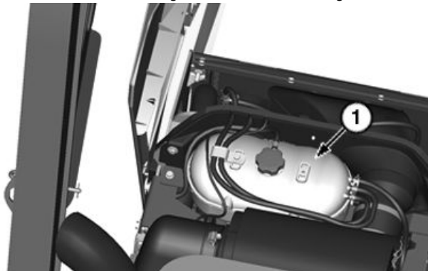
Vaso de expansión de refrigerante
